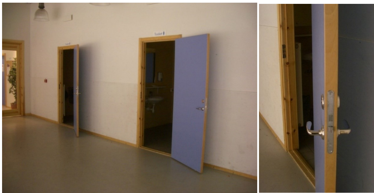
Figur 11. T.V. Öppna toalettdörrar mot ishallens arenarum. T.H. Oisolerade dörrar lämpar sig inte för att separera klimatzoner.
