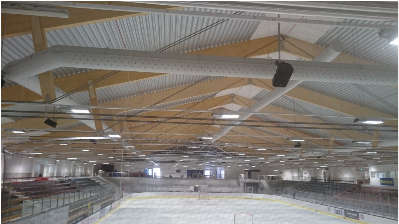
Figur 20. Textilkanal för både ventilation och avfuktning i en ishall.
