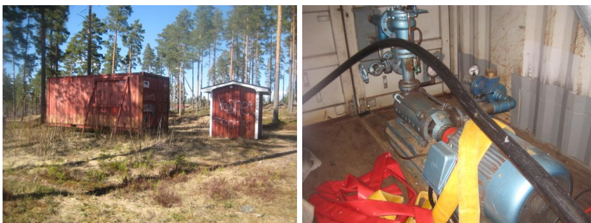
Figur 2-2: Pumphus och förråd med tillhörande högtryckspump
